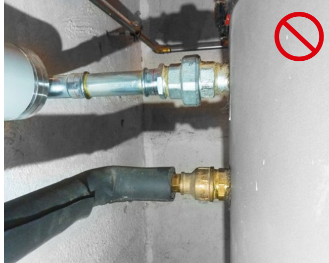
[FIG. 31] Cette installation présente plusieurs défauts : les raccords à l'accumulateur d'eau chaude ne sont pas isolés. L'épaisseur de l'isolant en caoutchouc synthétique ne correspond pas aux prescriptions. La fente n'est pas correctement fermée. De plus, pour éviter la convection naturelle, elle ne devrait pas être latérale, mais placée de préférence en dessous de la conduite. Selon les lois cantonales sur l'énergie, cette conduite doit être isolée au moyen de laine minérale.
