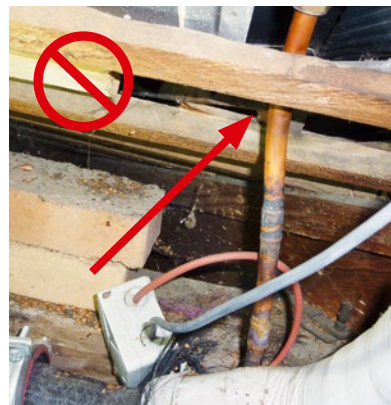
[FIG. 33] Bois en contact avec des conduites très chaudes.
