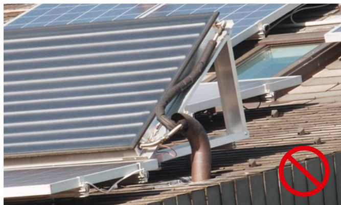
[FIG. 39] Le matériau isolant a glissé vers le bas. L'eau de pluie risque de pénétrer dans l'isolation et de là à l'intérieur du bâtiment. Les raccords au capteur ne sont pas isolés, le câble n'est pas tendu et exposé aux UV.
